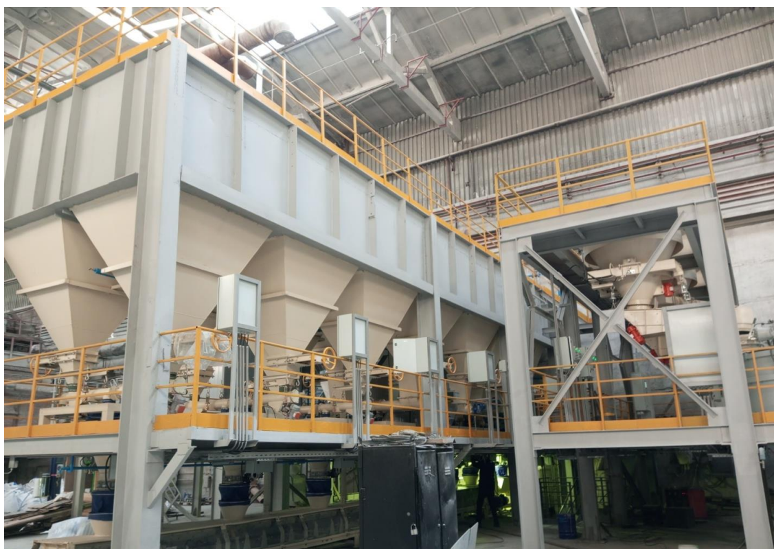
Рис. 4 Линия приготовления сухих огнеупорных смесей. г. Рудный (Казахстан)
